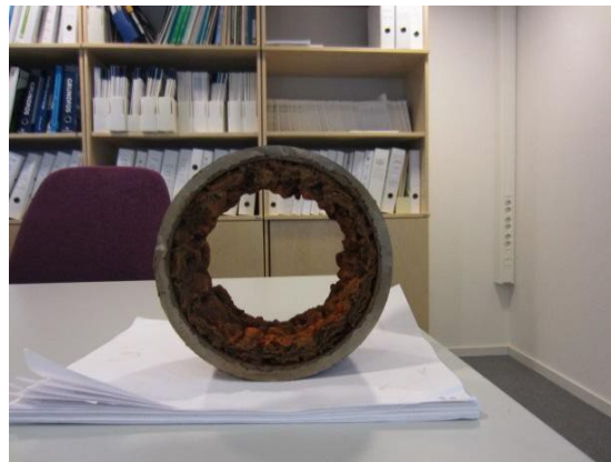
Grå støypejernsrør med rustknollar
