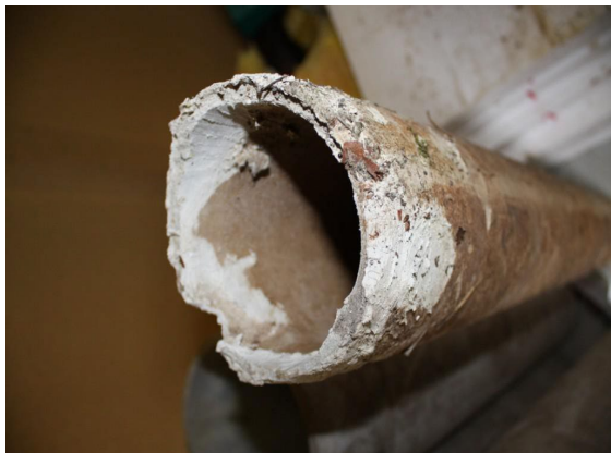
Asbest sement leidning i oppløysing
