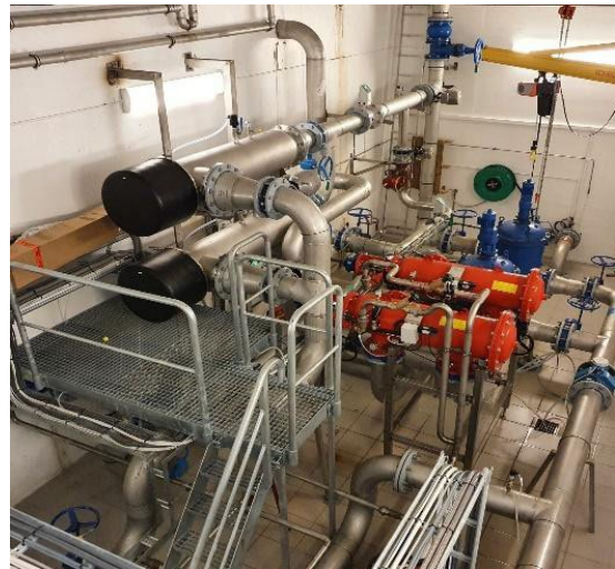
Maskin- og prosess trykksiler og UV-anlegg i kjeller
