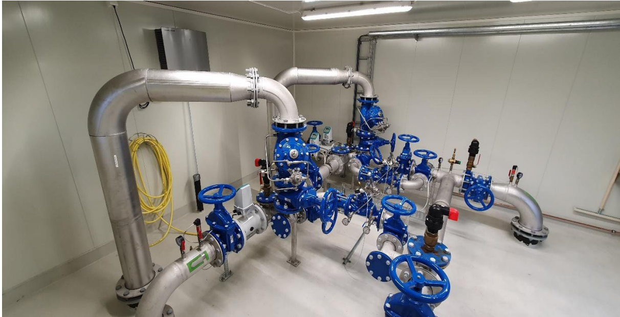
Ventilhus RV1 Hansgjerdet med reduksjonsventilar. Forsyning til Ulsteinvik og Dimna
