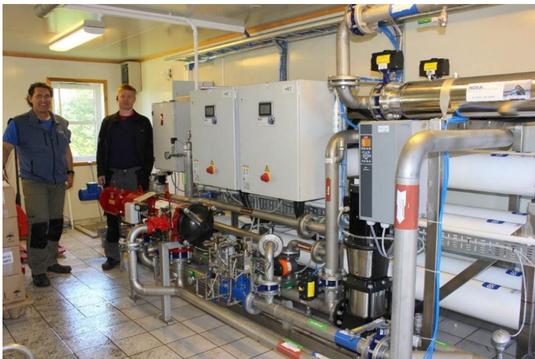
Flø vassbehandlingsanlegg – membranfilteranlegg (nanofiltrering)
