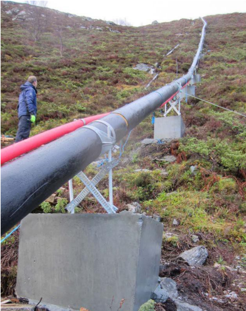
Leidning frå Garnesvatnet til Garsholhaugen vassbehandlingsanlegg
