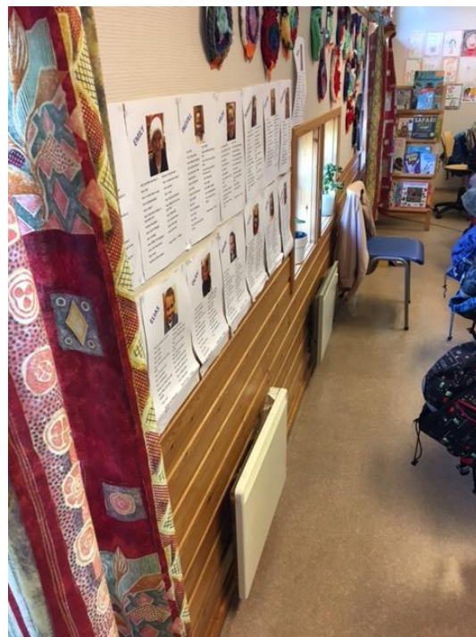
Bilde nr.10. Plassering av varmekilder, panelovner under vinduer i klasserommet.
