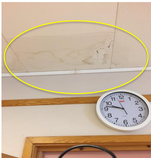
Bilde nr. 11. Gamle fuktskader (misfarginger) er synlig i gul sirkel.
