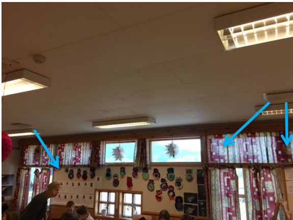
Bilde nr. 7. Innluften er markert med blå piler
